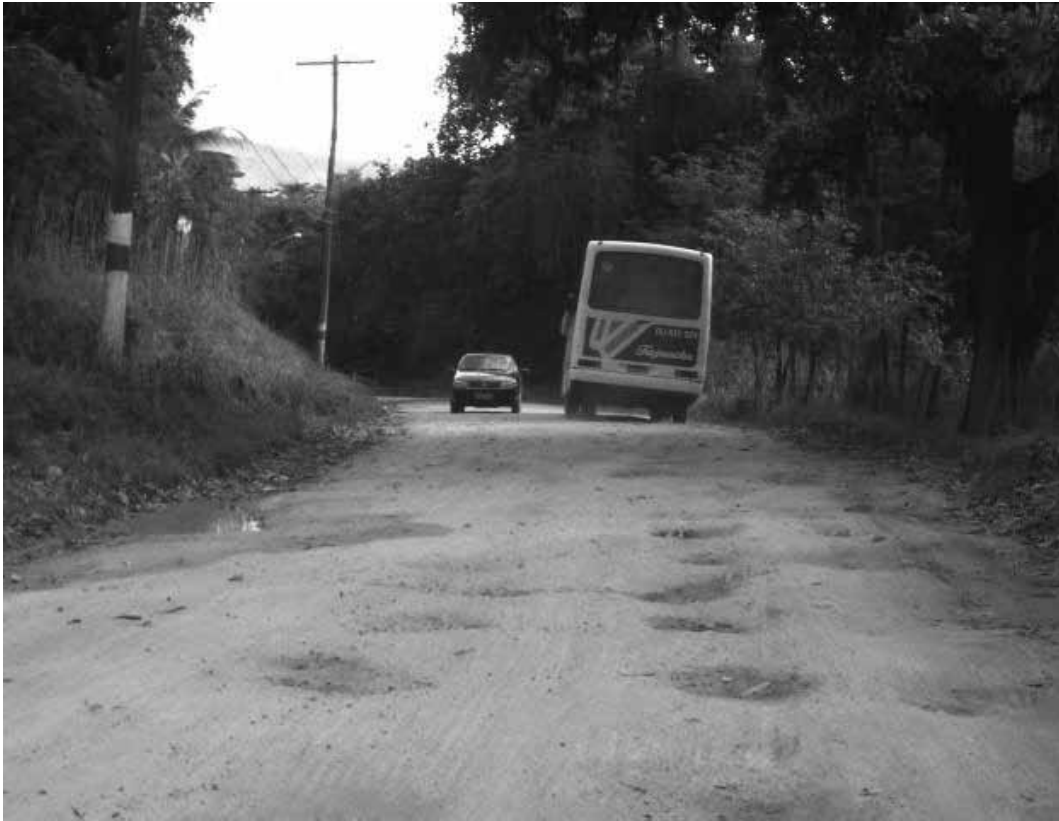
Figura 4. Estrada de acesso ao parque paleontológico. Note que a via é de terra e está esburacada (junho, 2011).
