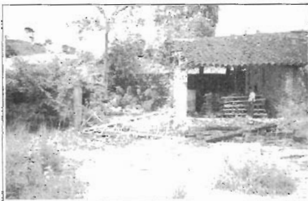
Fig. 5 - Segundo andar da caieira do Meio. Note que o telhado da plataforma que facilitava o transporte da cal está desabado, o que mostra a necessidade de restauração do patrimônio mineiro (SANTOS, 2007).
